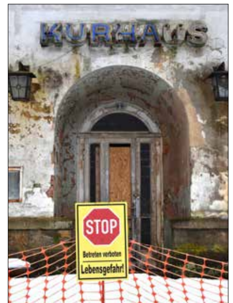
Bauffällig ist das Gebäude und darf nicht betreten werden
