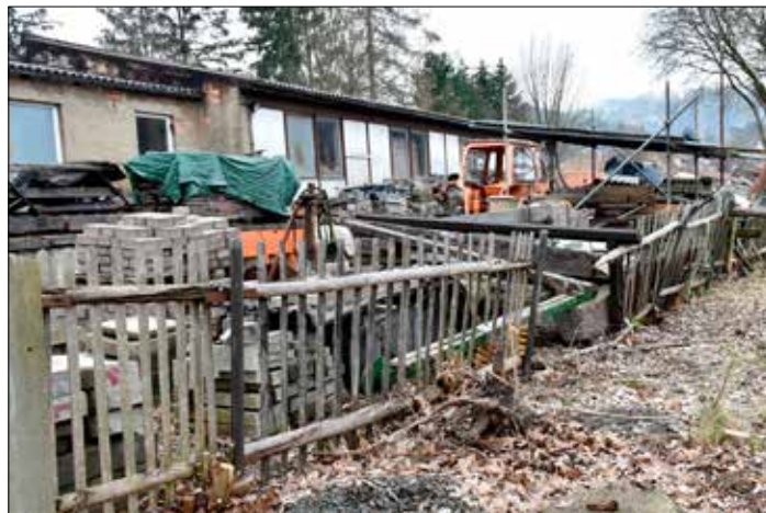
Mit der Rodung des Strauchwerks am Bauhof wurde der desolate Zustand sichtbar. Inzwischen erfolgte die Aufstellung eines Bauzaunes.
