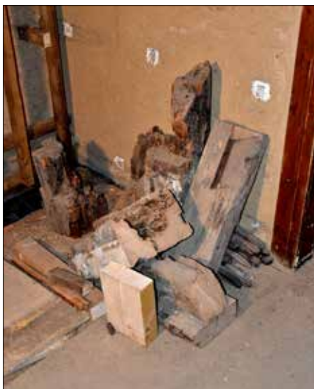
Mancher Balken scheint außen unversehrt, ist aber innen ziemlich hohl
