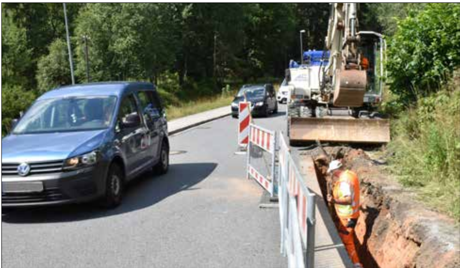
Per Ampelanlage wird der Verkehr in der Friedrich-Engels-Straße geregelt
