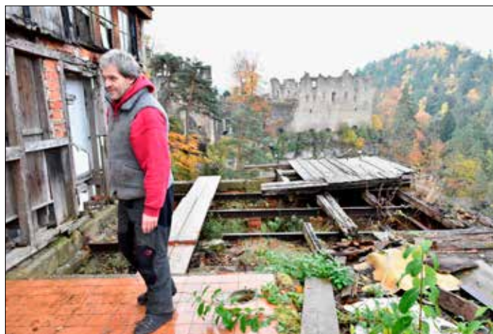
Das Plateau der früheren Toilettenanlage ist ebenfalls einsturzgefährdet
