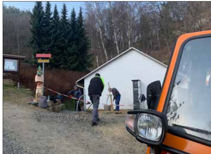
In unmittelbarer Nähe der E-Bike Ladestation wurden neue Fahrradständer installiert. Foto©Susann Neumann
